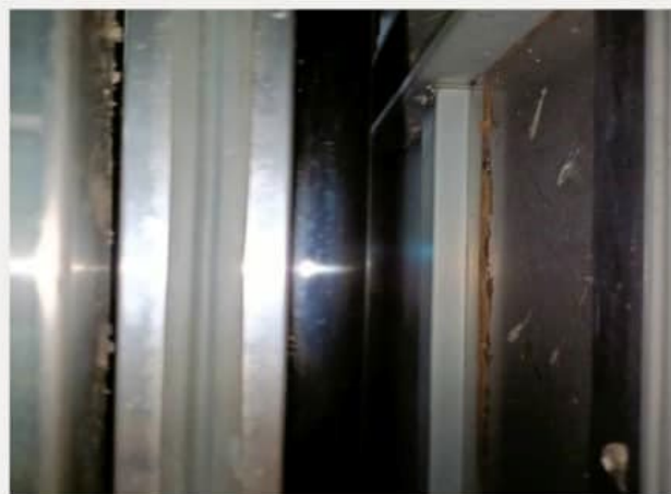
車廂防夾門控安全光幕損壞
