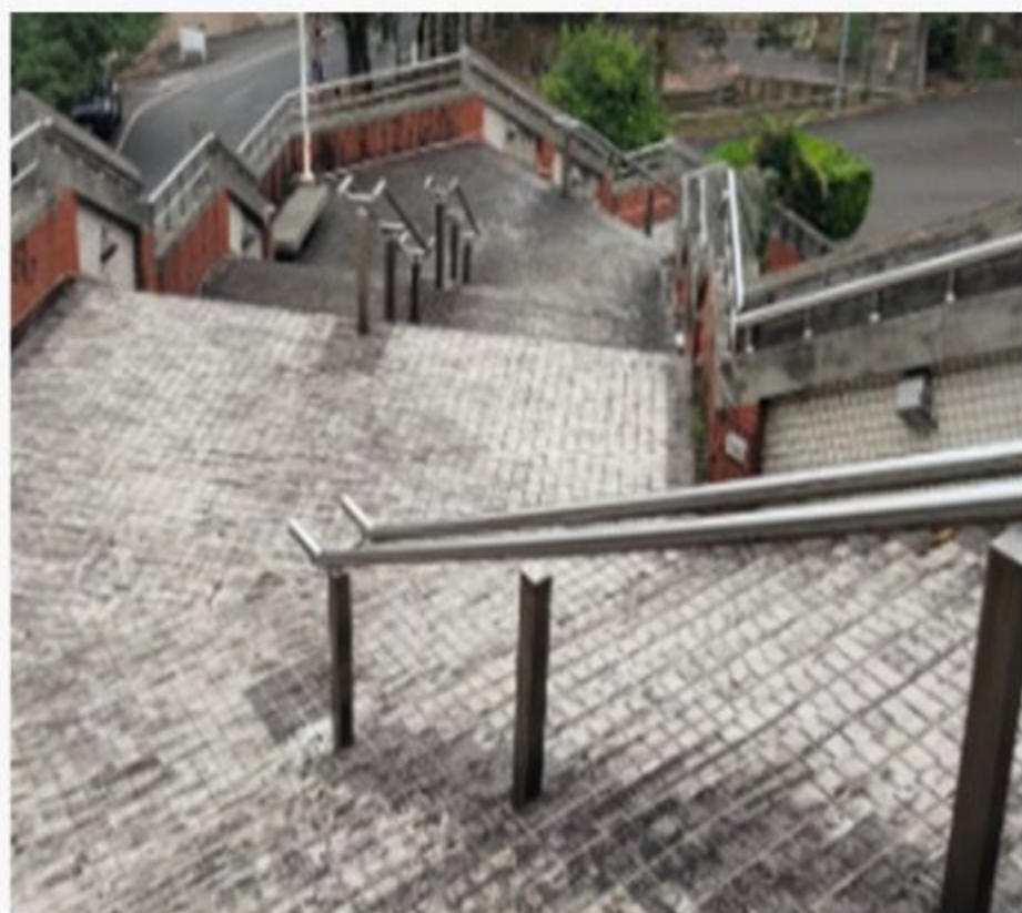
正面外牆及樓梯清洗前
